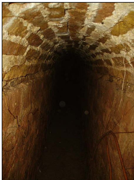
FOTO 30. Conducció localitzada a R1-162, vista al sud-est
