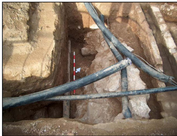
FOTO 6. R1-24. Farciment de la muralla afectat pel pas d'una canonada de ferro i d'una claveguera
