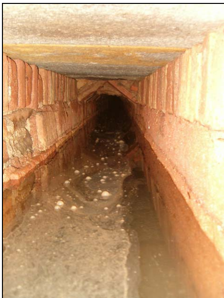
FOTO 23. Interior de la conducció a R1-46, en direcció est, amb presència d'aigua estancada
