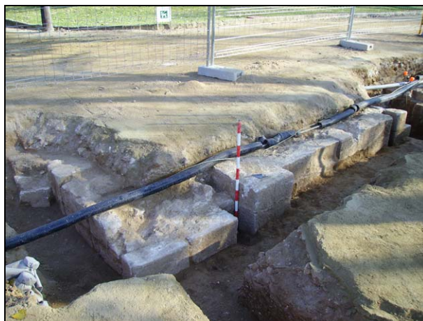
FOTO 14. R1-24. Part frontal del Portal de Sant Daniel. S'hi pot apreciar l'inici de la torre que defensava el seu angle nord-est
